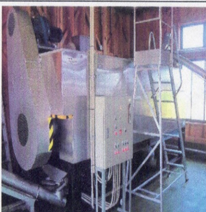
堆肥化された生ごみを乾燥貯留機で調製
