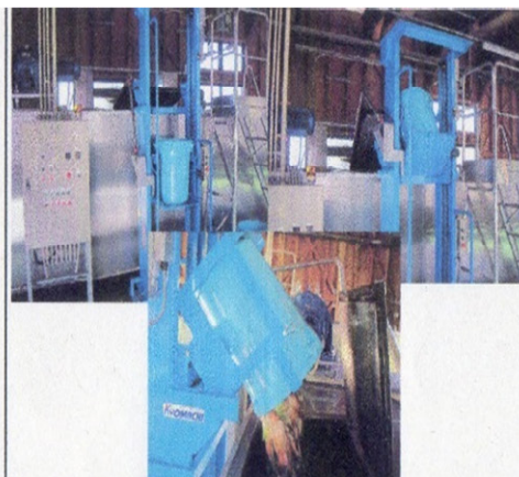
生ごみ投入機に乗せて生ごみを処理器へ投入
